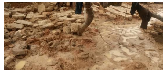
Destruction après les pluies du 5 septembre 2020 à Fada, Est. Photo ACF
