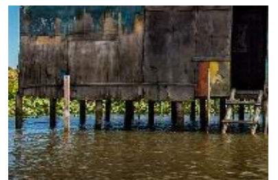
Palafitos afectados por la humedad y el aire debido a las mareas de la Laguna de Sinamaica - CC Luis Angel Chamargo
