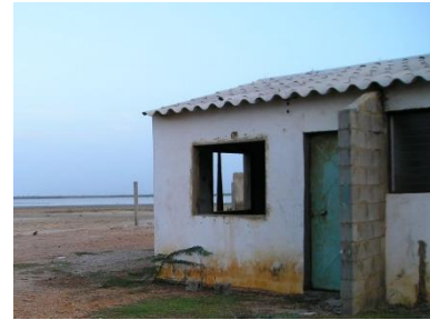
Vivienda con techo de asbesto, material cancerígeno peligroso para la salud. San Juan de los Cayos, Estado Falcón - CC Gary Hans
