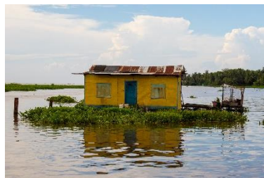
Vivienda palafítica híbrida con materiales industriales que ha perdido sus cualidades térmicas - CC Paul Rose
