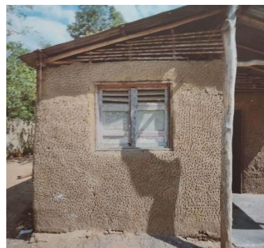
Pañete irregular con marcas de dedos que permiten reducir la erosión del muro por lluvia. San Fernando, Estado Sucre – Gasparini ©
