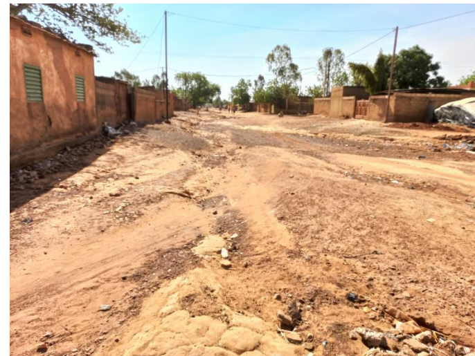
Une rue montrant des problèmes d'aménagement et de ruissellement incontrôlé des eaux de pluie
