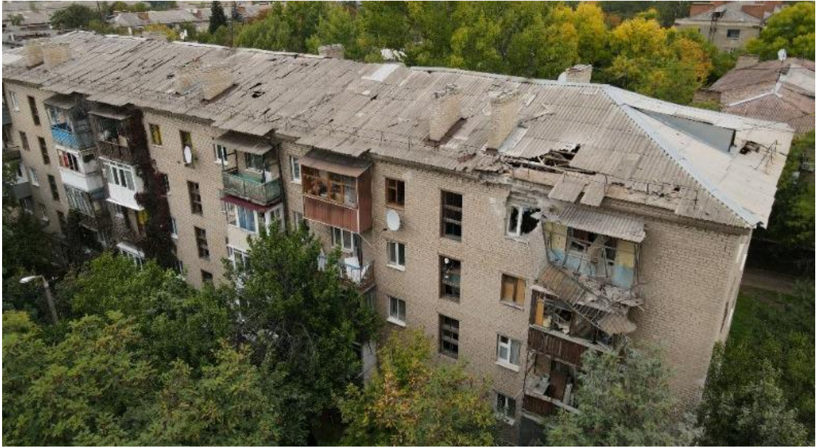
Рисунок 2 – Пошкоджений шатровий дах багатопверхового будинку, м. Краматорськ, джерело https://www.kramatorskpost.com/
