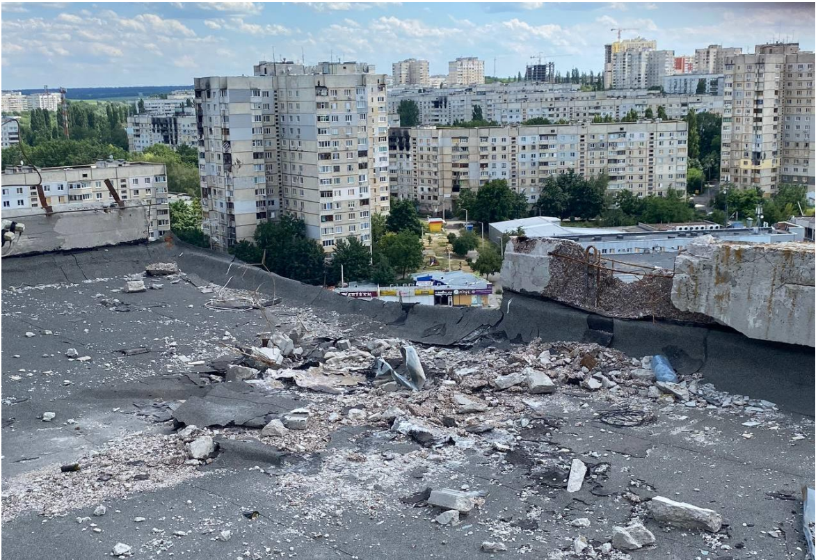
Рисунок 3 – Пошкоджений плоский дах багатопверхового будинку (з частковим руйнуванням парапету), м. Харків, джерело https://dream.gov.ua/
