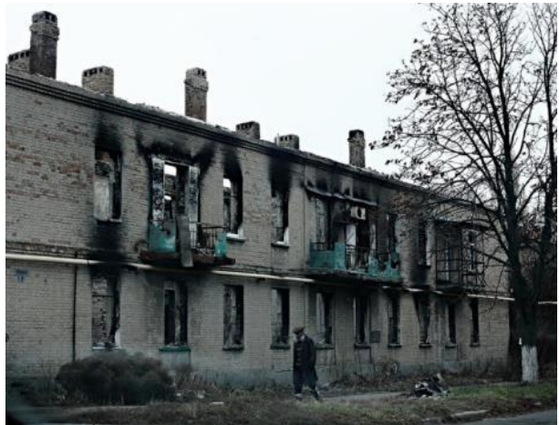
Рис. 8 - Результати пошкодження цегляної будівлі при пожежі
