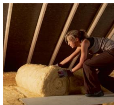
Рис. 31 - Ізоляція на горищі, об'єм горища підвищує теплові характеристики
